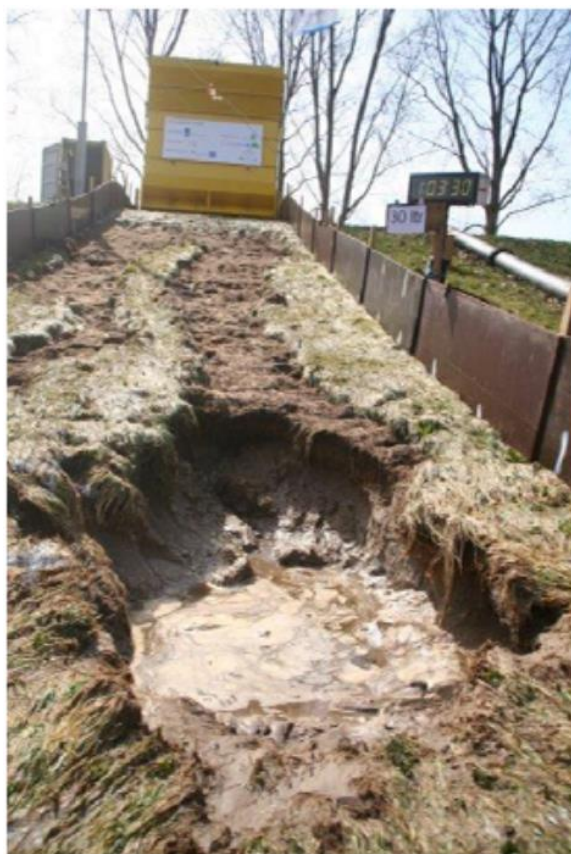
Figur 4-1 Eksempel af dige med "failure" af græsset og det øverste jordlag.
